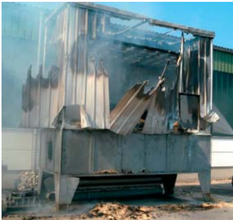
Fig. 16 Danni dovuti all'esplosione
