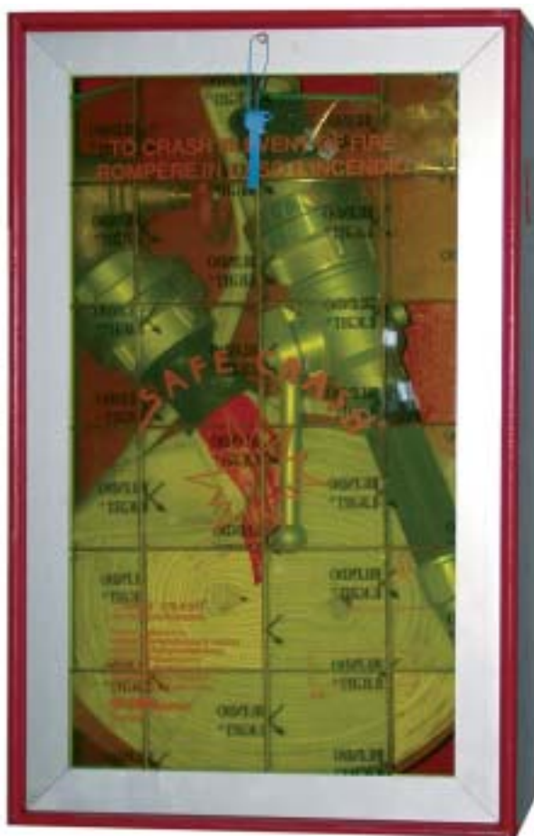
Fig. 14 Idrante a muro - per impianti silos piccoli può essere sufficiente un idrante a muro
